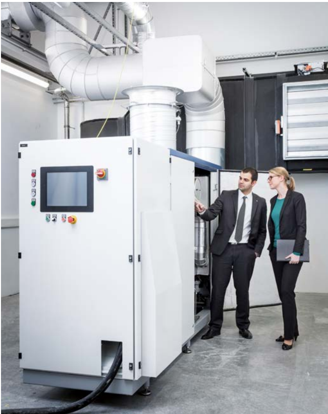
Das Compact Power System (CPS) von Dürr erzeugt mit einer Mikrogasturbine Wärme und Strom. Daneben Corinna Wehle mit Vertriebsingenieur Daniel Barunovic
