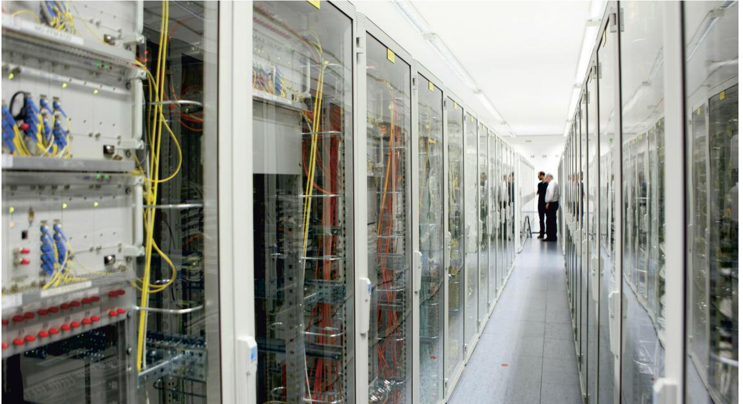
Serverzentrale – Verarbeitung von Kunden- und Produktdaten der neuen Commerzbank
